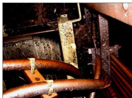
Kurzschluss durch erhöhten Wassergehalt des Isolieröls
