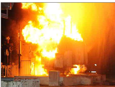
Brand durch verminderte Durchschlagsfestigkeit
